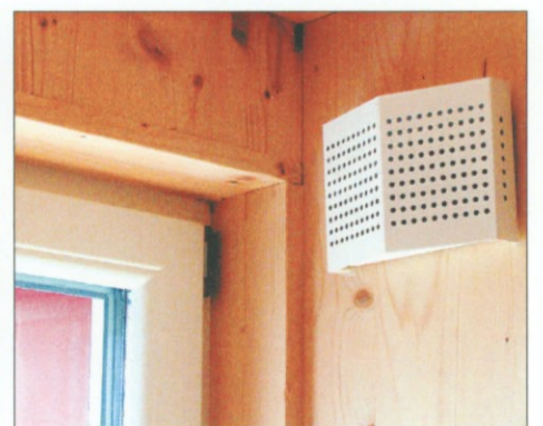
Über solche Eingangsschleusen gelangt die gefilterte Frischluft in die Räumlichkeiten.
