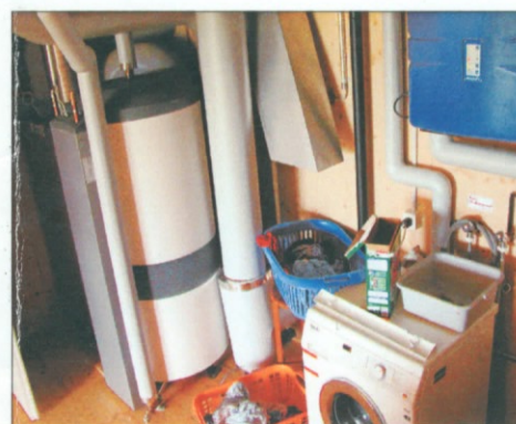
Nur wenig Platz beanspruchen die Haustechnik-Installationen mit Regenwassernutzanlage.
