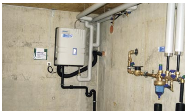
Récupération d'eau météorologique
